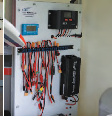
Auf der senkrechten Schalttafel befinden sich mehrere Anschlüsse für „Bananenstecker“. Auch der Solarregler und auch der zugehörige Wandler ist hier fix montiert.
